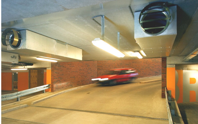
Abb. 4 Jet-Ventilatoren in der Ein- und Ausfahrt
