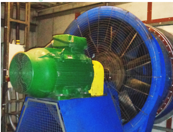
Alter Ventilator von 2012 vor dem Umbau
