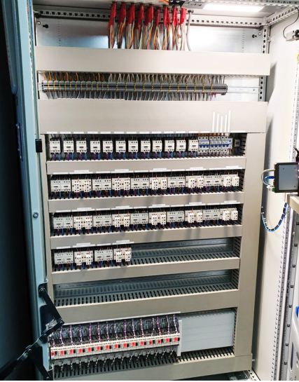
Jet fan control panel
